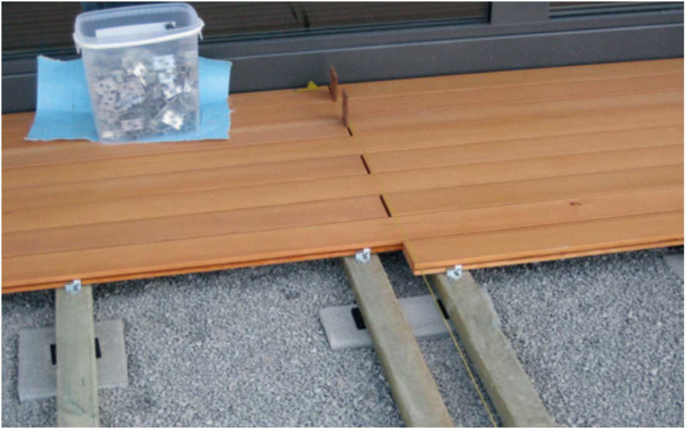
Konstruktiver Holzschutz: Die einzelnen Holzbretter schliessen nicht direkt aneinander an, Feuchtenester können so gar nicht erst entstehen.
