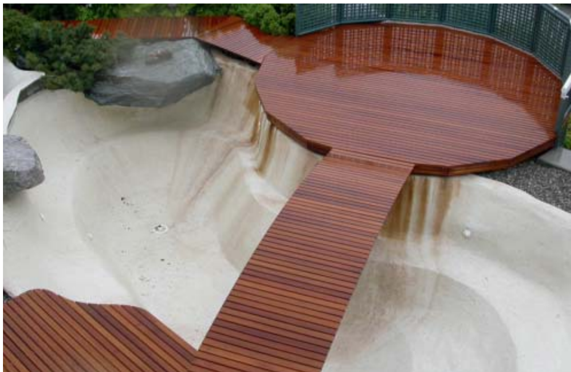
Nach einer ersten Bewitterungsphase war die Poolwand durch austretende Inhaltstoffe verfleckt.
