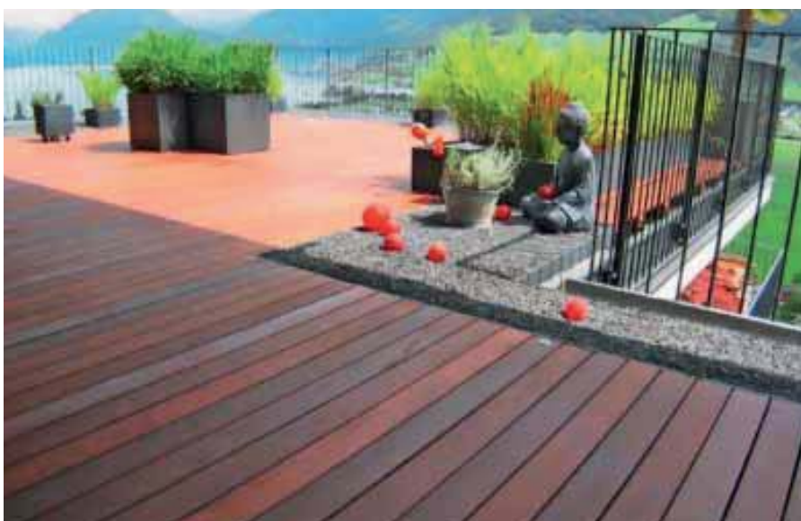
Nach der Neuverlegung: Mahagoni Sipo erfüllte die Erwartungen der Bauherren und Eigentümer. Die Holzterrasse ist nun unter anderem barfussstauglicher..
