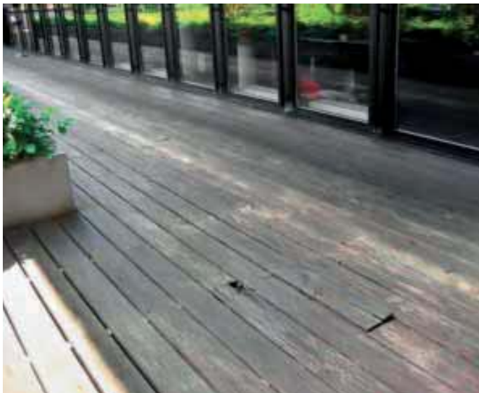
Anderes Objekt, ähnliche Szene: Nach fünf Jahren weist dieser Douglasienrost bereits erste Faulstellen auf.
