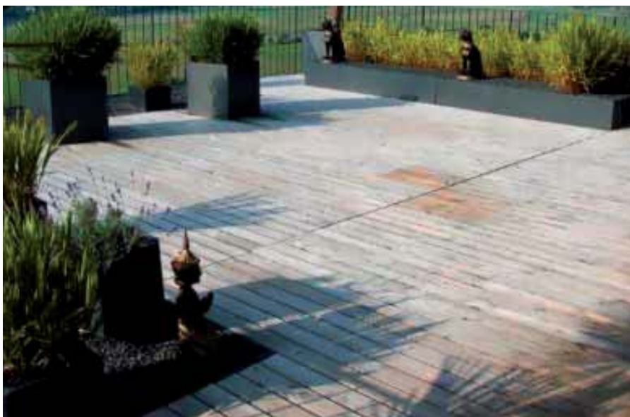
Das Rost aus Douglasie in einer minderen Qualität: Schon nach drei Jahren hatte die Witterung Spuren auf dem Holz hinterlassen.
